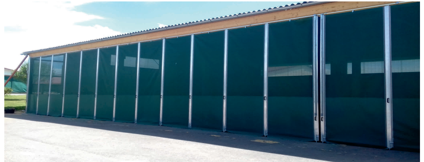
Kostengünstige Lösung mit Schiebevorhängen für eine große Fuhrparkhalle - Laub und Schmutz bleiben hier draußen
