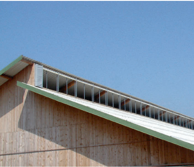
A-System zur Lüftungsregulierung auf dem Scheddach
