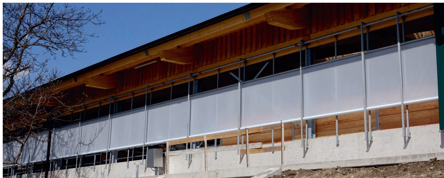
C78 Windschutz Anlage in Beschattungsstellung für Frischluft am Freßtisch und Entlüftung im oberen Stallbereich
